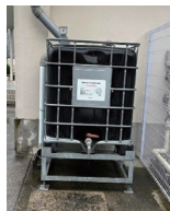
小学校に設置されている貯水タンク
